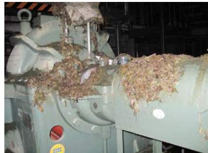
被水した海水ポンプ （後日撮影のもの）
