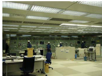
津波到達後の中央制御室
