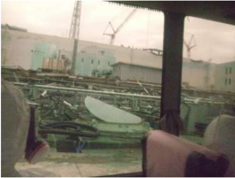
←海水ポンプ周辺（1～4号） （車内より撮影）
