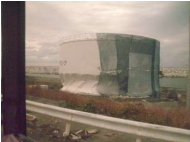
←サブプレッションプールサ ージタンク（5，6号機用）
