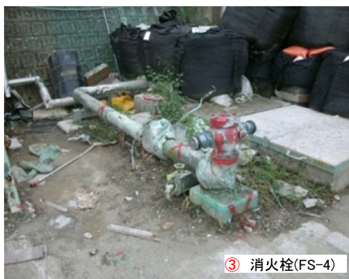
③ 消火栓(FS-4) 平成23年8月24日 東京電力撮影
