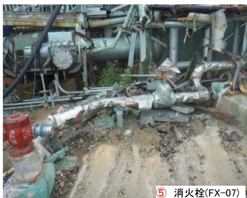
⑤ 消火栓(FX-07) 平成23年8月24日 東京電力撮影
