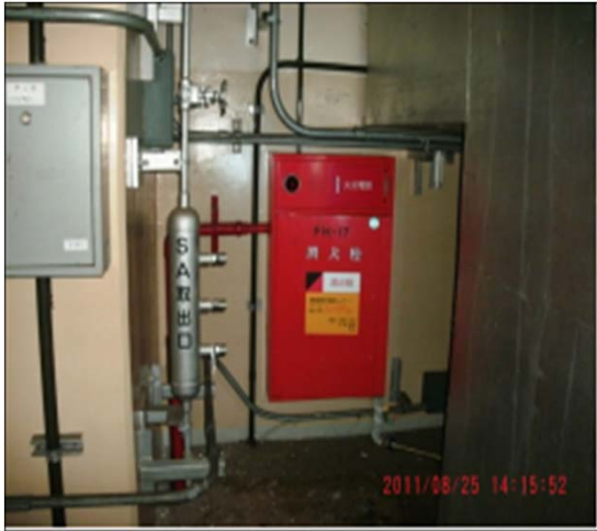
平成23年8月25日 東京電力撮影 2階の消火栓(FH-17)
