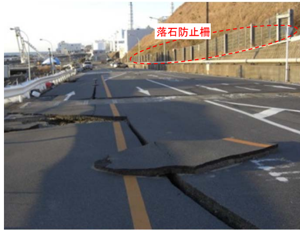
海側片車線が道路と平行に割れ段差が発生。西側の通行は可能。 「平成23年3月17日 東京電力撮影」
