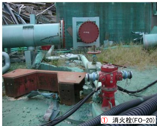
① 消火栓(FO-20) 平成23年8月24日 東京電力撮影
