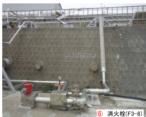
⑥ 消火栓(F3-8) 平成23年8月24日 東京電力撮影
