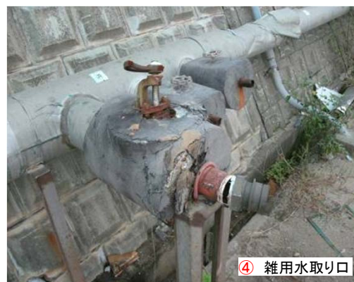
④ 雑用水取り口 平成23年8月24日 東京電力撮影
