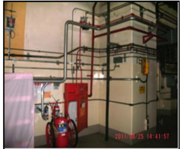
平成23年8月25日 東京電力撮影 2階の消火栓(FH-18)
