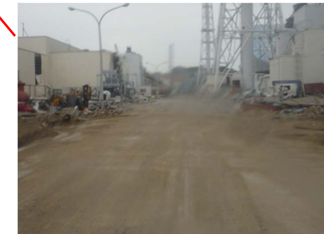
1~4号機西側道路は特に異常なし。1,3,4号機R/B損壊時には瓦礫散乱があった。 「平成23年3月20日 東京電力撮影」
