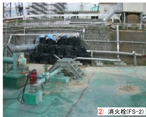
② 消火栓(FS-2) 平成23年8月24日 東京電力撮影
