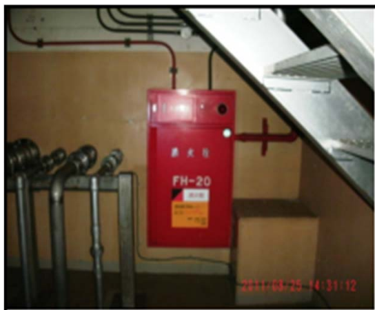
平成23年8月25日 東京電力撮影 2階の消火栓(FH-20)
