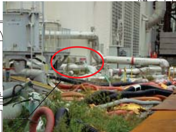
※平成22年6月竣工 原子炉注水に使用
