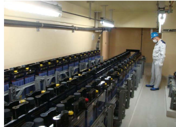
125V蓄電池室の例
