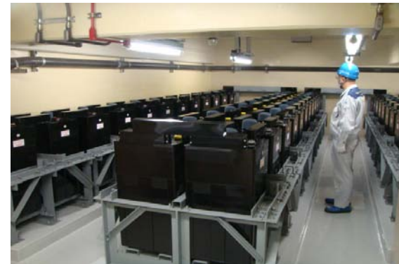
250V蓄電池室の例
