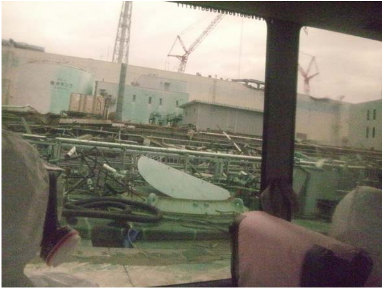
←海水ポンプ周辺（1～4号） （車内より撮影）
