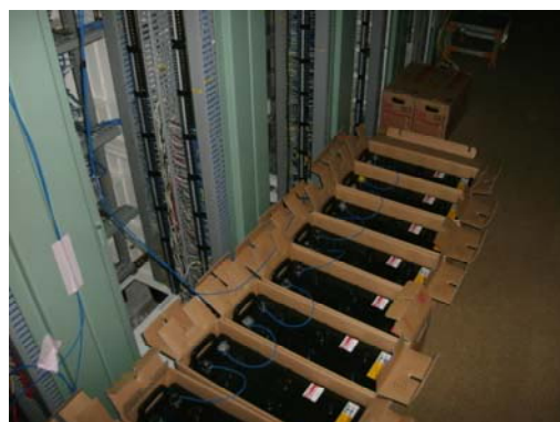
バッテリー12V×10個直列 (後日撮影 照明あり)
