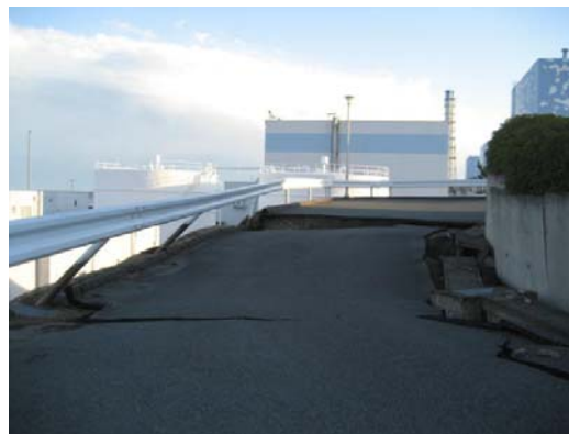
ひび割れて通行不可になった構内道路
