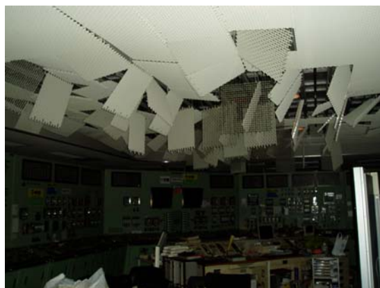
爆発後の中央制御室の状況
