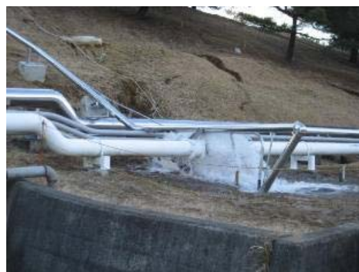
変圧器防災配管の漏えい
