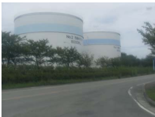
ろ過水タンク
