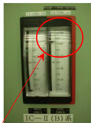
IC(B) 蒸気圧力計、水位計 （後日撮影）
