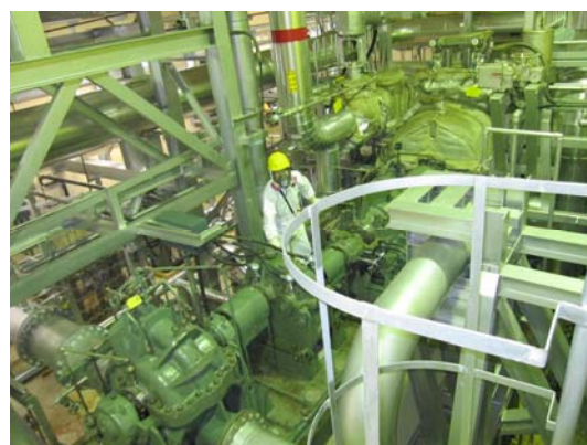
HPCI (5号機 照明あり)
