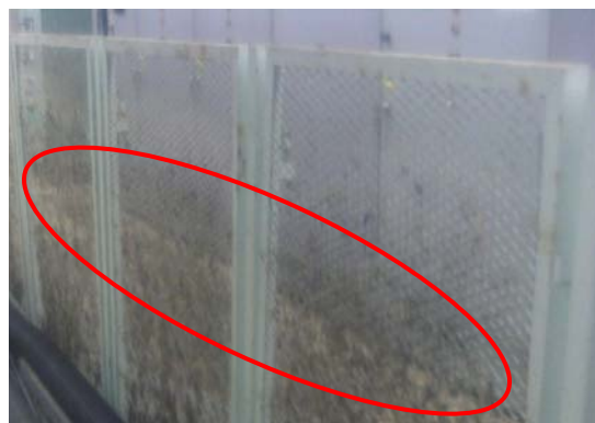
1号機タービン建屋1階M/Cの状況
