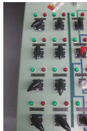
SRV 制御盤（後日撮影）
