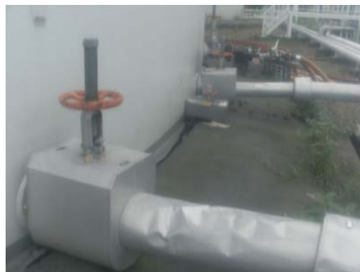
ろ過水タンク周りのタンク出口弁 〔原子炉注水に必要な FP ライン以外の出口弁は閉とした。〕
