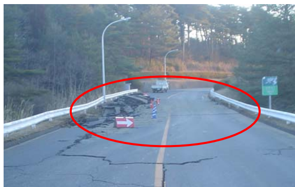
5,6号へのアクセス道路の損傷状況 (復旧後の状況。片側の道路の舗装をはいで、 碎石や砂利を流用して片側車線を復旧)
