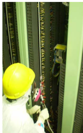
制御盤裏 (後日撮影 照明あり)
