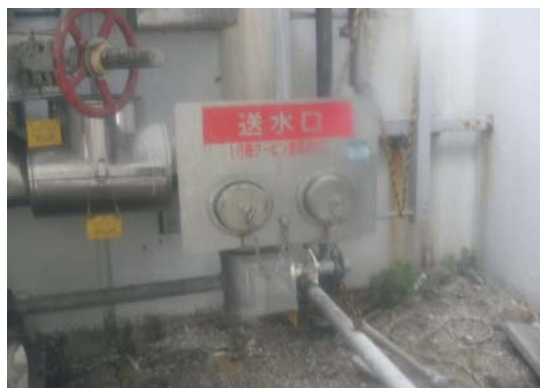
1号機消火系送水口
