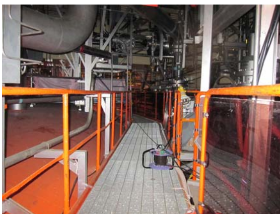
キャットウォーク (5号機, 照明あり)
