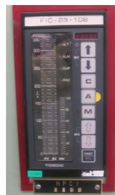
HPCI 流量制御器 (FIC) (後日撮影)
