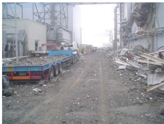
トレーラや瓦礫を脇へ寄せた後の3/4号機変圧器エリアの様子(後日撮影)
