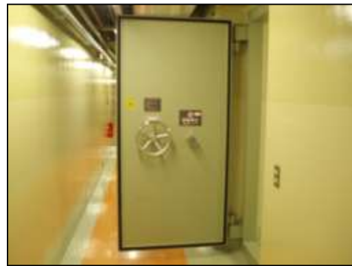
⑥原子炉隔離時冷却ポンプ室扉
