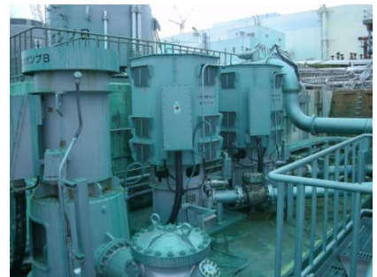
1号機格納容器冷却海水系ポンプ
