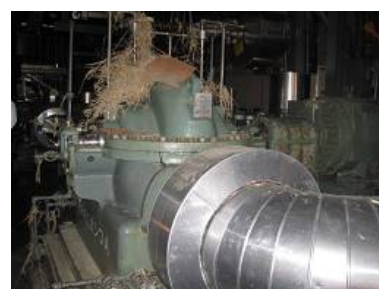
被水した1号機残留熱除去海水系 中間ループ循環ポンプ
