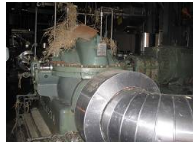
被水した1号機残留熱除去海水系 中間ループ循環ポンプ
