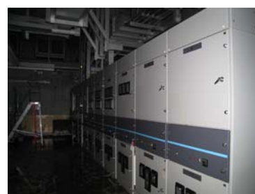
被水した1号機M/C電源盤 (床面水有り)
