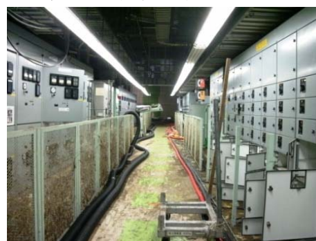
被水した1号機タービン建屋1階電源盤
