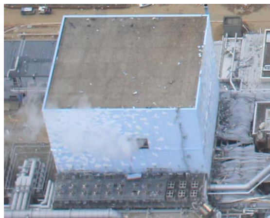
2号機ブローアウトパネルの開放状況
