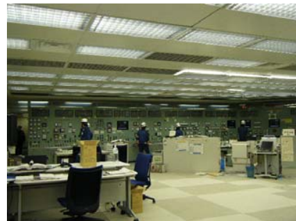
津波到達後の中央制御室
