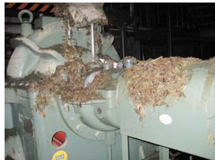
被水した冷却水ポンプ （後日撮影のもの）
