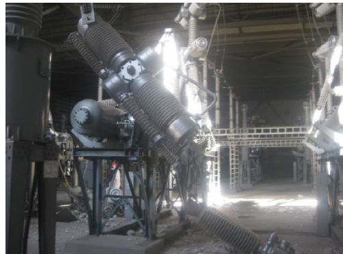
開閉所の遮断器が損傷して一部が落下
