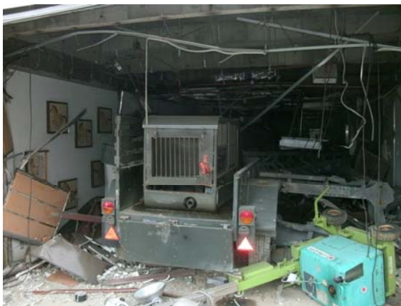
自衛隊低压電源車。トレーラーに小型発電機が積載されたもので、移動には牽引が必要（後日撮影）
