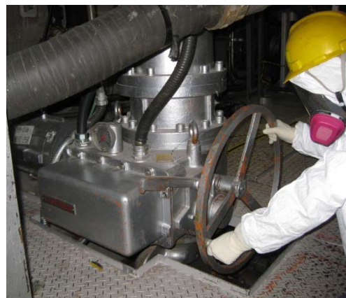
RHR注入弁操作イメージ(5号機 照明あり)
