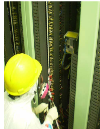
制御盤裏 (後日撮影 照明あり)
