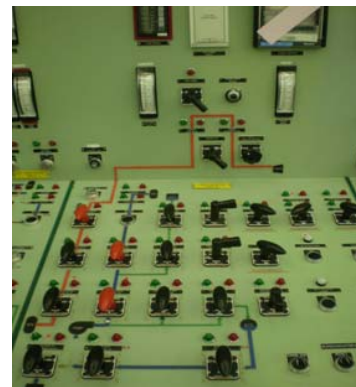
HPCI 制御盤（後日撮影） 当時、状態表示灯は全て消灯
