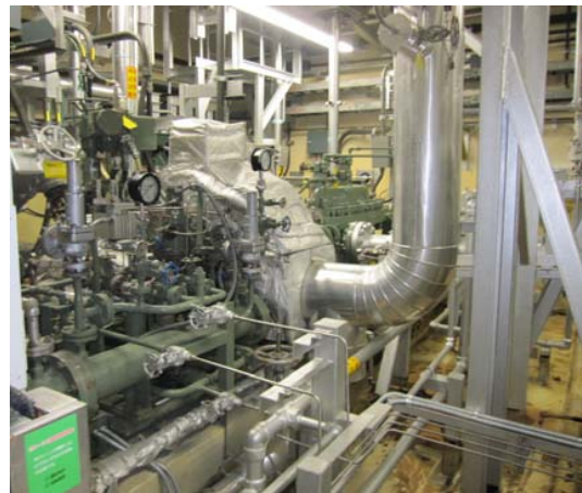
RCIC（5号機 照明あり）
