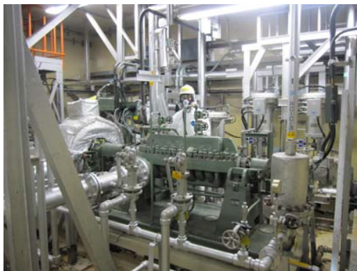
RCIC (5号機 照明あり)
