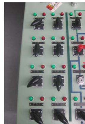
SRV 制御盤（後日撮影）
