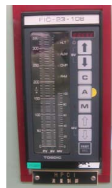
HPCI 流量制御器(FIC) (後日撮影)
