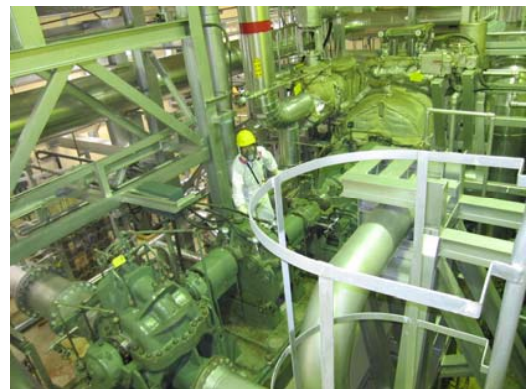
HPCI (5号機 照明あり)
