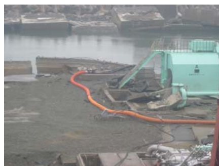
水中ポンプの設置状況 (配置は後日のもの)
