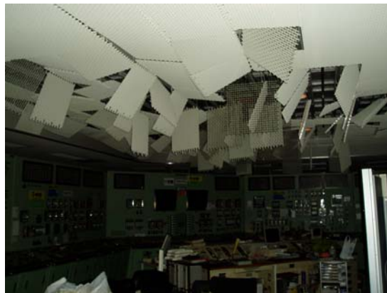
爆発後の中央制御室の状況
