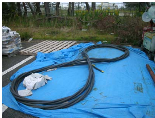
写真のケーブルは約 15m で重さは約 90kg。1,2 号の電源復旧はこの 10 倍以上の長さを使用。(後日撮影)
