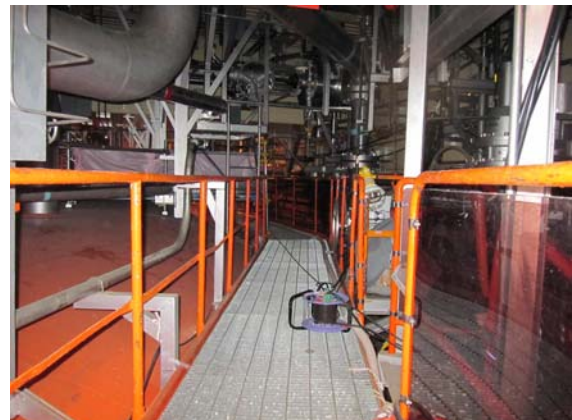
キャットウォーク (5号機, 照明あり)
