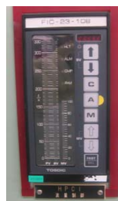
HPCI 流量制御器(FIC) (後日撮影)
