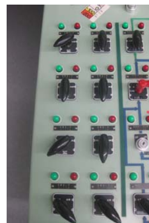
SRV 制御盤（後日撮影）
