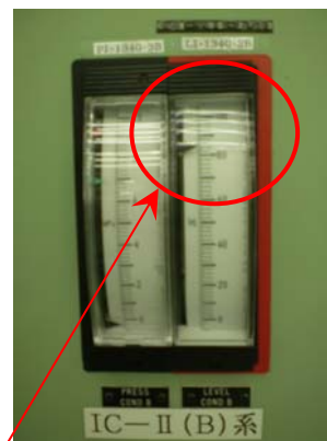
IC(B)蒸気圧力計,水位計 （後日撮影）
