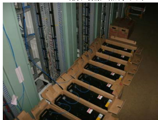
バッテリー12V×10個直列 (後日撮影 照明あり)
