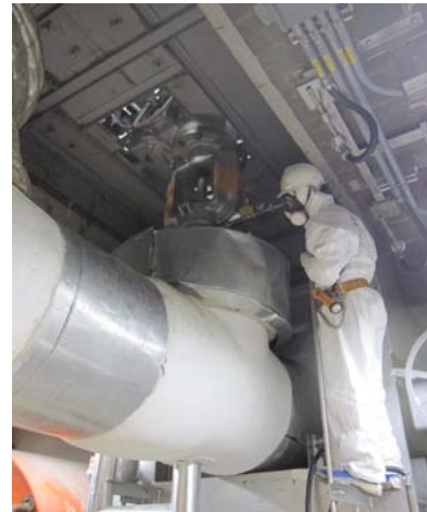
直径約 60cm の配管に設置されている RHR 注入弁 (5号機 照明あり)
