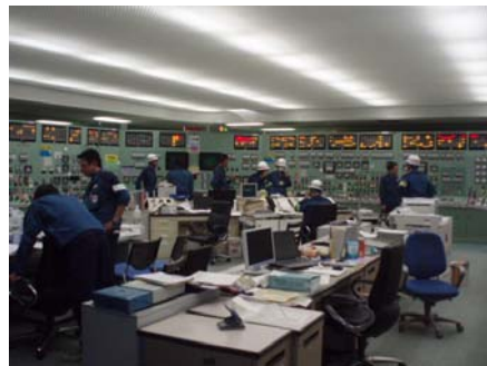
5,6号機中央制御室：6号機側
