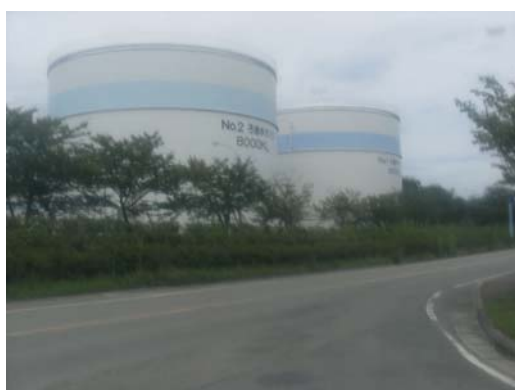
ろ過水タンク
