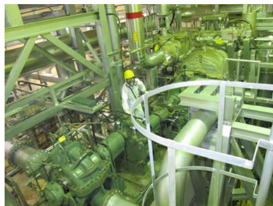
HPCI (5号機 照明あり)
