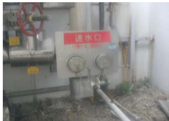
1号機消火系送水口
