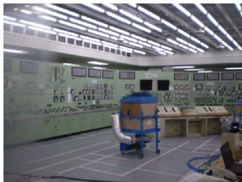
1,2号機中央制御室（後日撮影）
