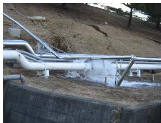
変圧器防災配管の漏えい
