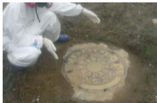
防火水槽の取水蓋
