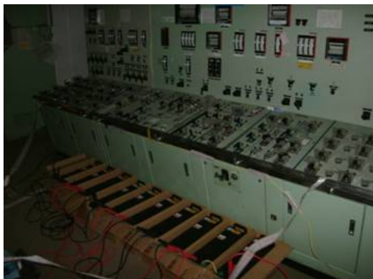
仮設バッテリーをつないで計器用電源として使用
