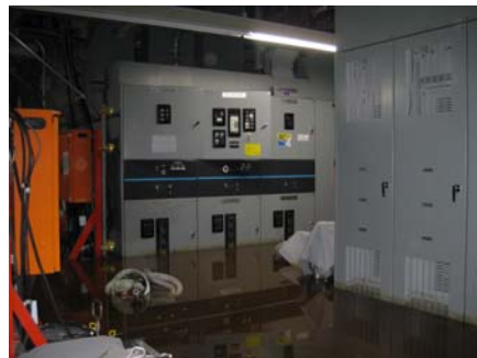
6号機電気品室の浸水状況
