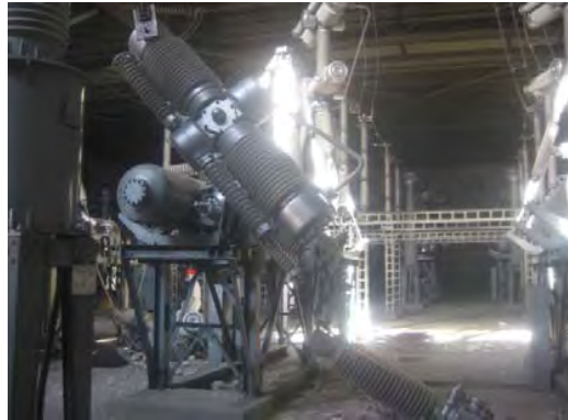
図1 福島第一原子力発電所 大熊線1L遮断器
