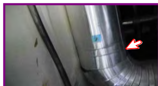
IC(A)凝縮水戻り配管
