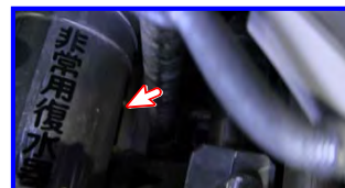
IC(B)凝縮水戻り配管
