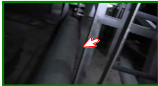
IC凝縮水戻り配管
