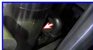
IC(B)凝縮水戻り配管
