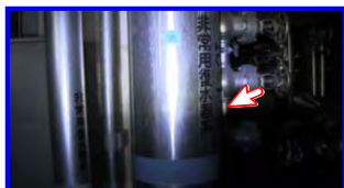
IC(A)凝縮水戻り配管
