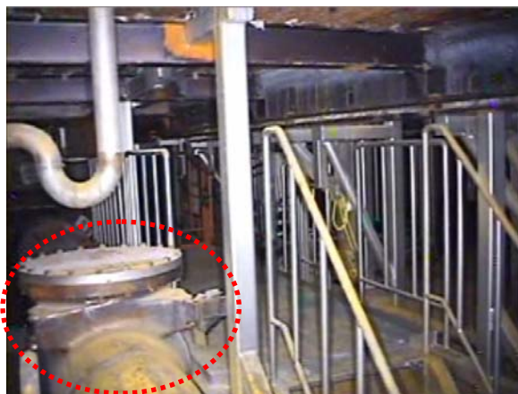
図 2-3 1号機トールス室内 S/C 真空破壊弁のカメラ映像（抜粋）
