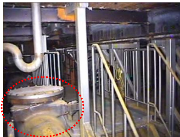
図 2-3 1 号機トールス室内 S/C 真空破壊弁のカメラ映像（抜粋）
