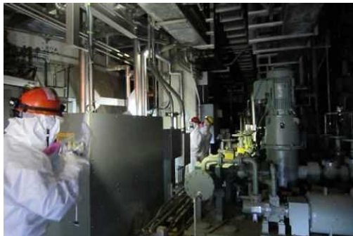
2階の損傷は軽微
