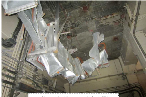
4階の通気ダクトは大きく損傷
