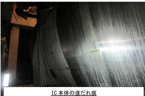
IC本体の液だれ痕 委員意見：4階で配管等が破損し、蒸気が漏洩した痕跡ではないかと。 東電説明：3階でも確認。5階からの回り込みや湿分の影響等も考えられる。4階で蒸気が漏洩した根拠とはならない。
