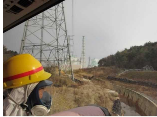
夜ノ森線鉄塔倒壊現場
