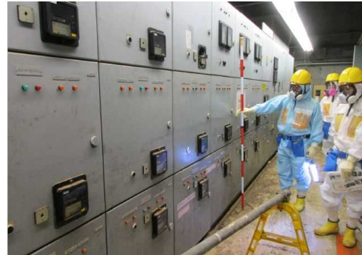
非常用高圧電源盤
