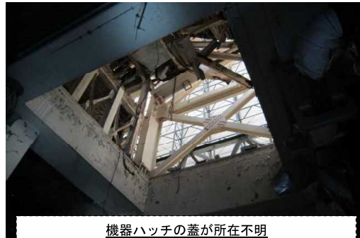
機器ハッチの蓋が所在不明 委員意見：4階で水素が漏洩して爆発したことを示唆しているのではないかと。 東電説明：解析結果から上へ飛ぶ可能性も下に落ちる可能性もある。爆発箇所を特定する根拠にならない。
