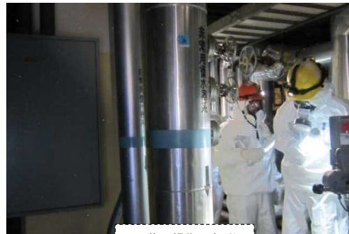
3階の損傷は軽微
