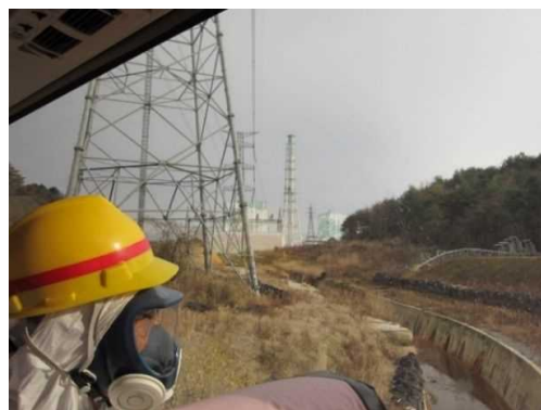
夜ノ森線鉄塔倒壊現場
