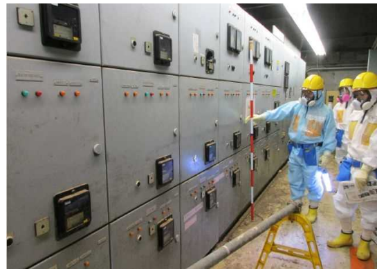
非常用高圧電源盤
