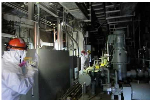
2階の損傷は軽微
